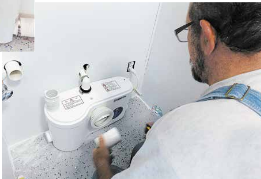
L'entrepreneur en plomberie Rowdy Gifford installe les pompes de broyage Sanibest Pro de Saniflo à l'intérieur de l'autobus « Showering Love »
